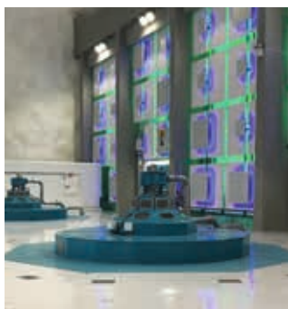
LYSE 2: Vannkraftverk, Rogaland. Foto: Redaksjon.
